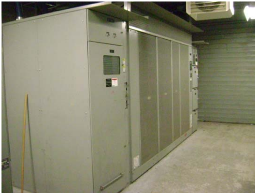
Westinghouse DS 416 Breakers
