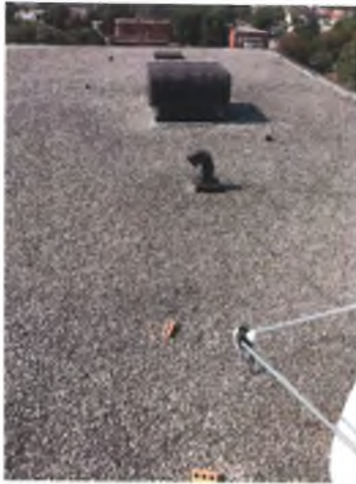
345 - roof top exhaust fan
